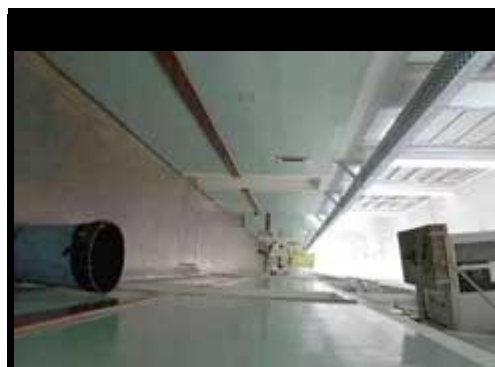
Azevedo ainda apontou outras carências da unidade. UFMT diz que aguarda recursos para reparos como a troca da caldeira, a R$ 300 mil
